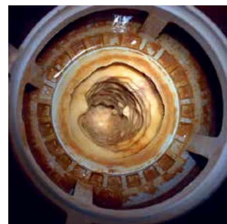
Verkalktes Spülrohr nach 10 Jahren.
